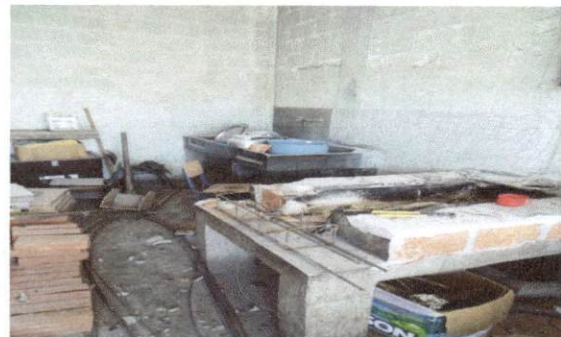
Foto 4: Forro de azulejo en estufa de leña, mejoramiento y restauración en espacio de combustión
